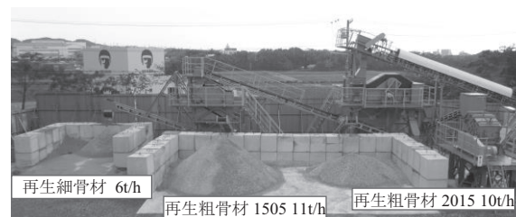
写真2 再生骨材製造プラント外観(B工場)
